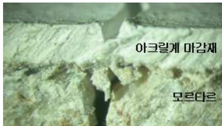
그림 14. 아크릴계 표면마감재에 있어 상부도막층의 파단현상 (모르타르 균열 1.0mm)
